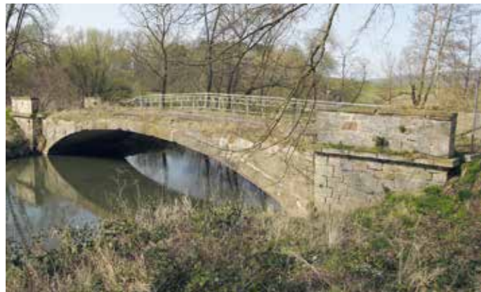
Ein Erhalt der schlanken, um 1920 erbauten Pletschmühlenbrücke über der Ohm in Homberg gilt als zu teuer. Foto: Klaus Foehl / Wikimedia Commons, 2014
